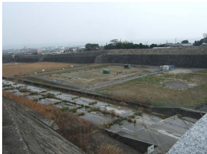
写真-5 飛び石の必要な箇所 平成 24 年 3 月 高橋和雄 撮影
