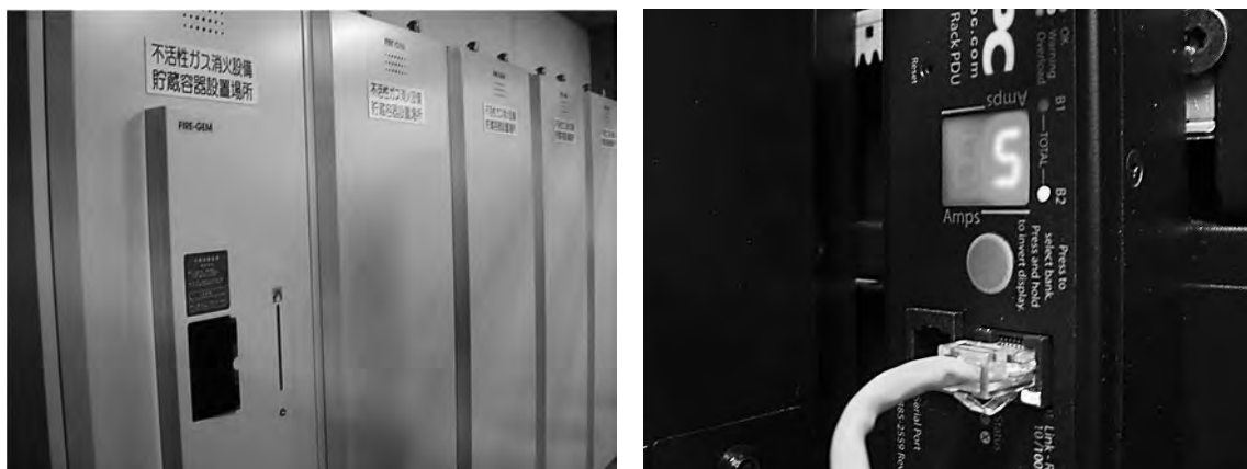
図2：窒素自動消火装置と電力モニタ・分配装置
