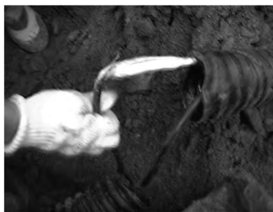
図5：折損した光ケーブルと管路
