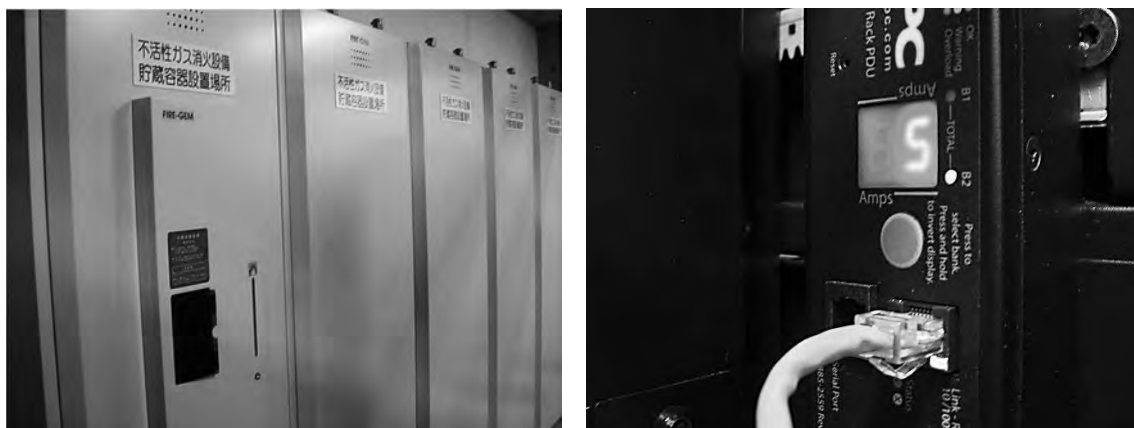
図2：窒素自動消火装置と電力モニタ・分配装置
