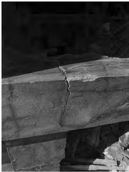
写真-3.1.10 30号棟劣化4
