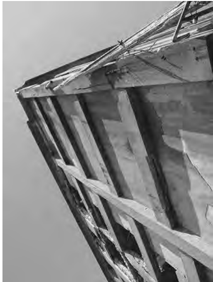
写真-3.1.8 30号棟劣化2
