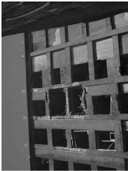
写真-3.1.7 30号棟劣化1
