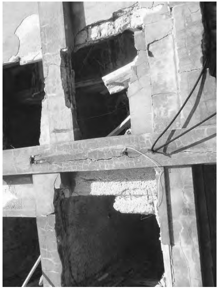
写真-3.1.9 30号棟劣化3
