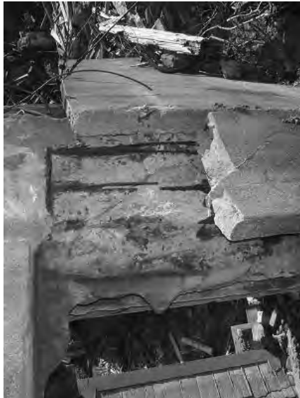
写真-3.1.11 30号棟劣化5
