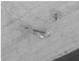
橋裏の鉄筋むき出し
