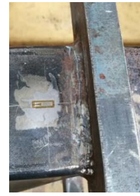
Photo4 RM4520 溶接部の亀裂の様子
