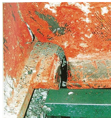
写真 3 鉄骨建物の地震被害 3)
