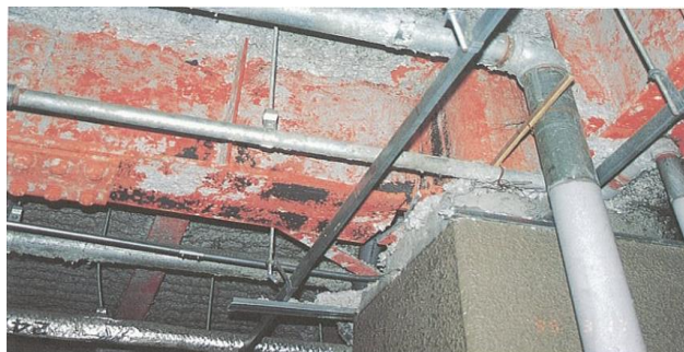
写真 2 鉄骨建物の地震被害 2)
