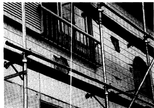
写真6 建物の外壁の被害。主に瓦の飛来による外壁の損傷である。ここでは補修の足場が組まれている。
