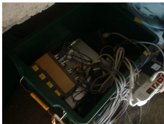
図-16 計測機器設置状況 (改善前)
