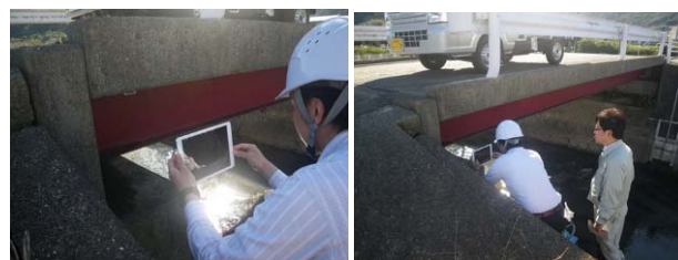
図8 プレットを用いた損傷部位の撮影とデモ
