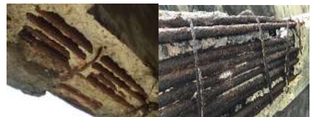
図 15 桁下の鉄筋露出(左 G1, 右 G4)
