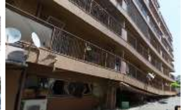
写真 1-2 対象構造物①の被害
