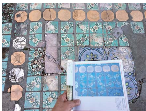
図 16: 玄関ポーチの一部を北側から撮影した。撮影者が手にしているのは1980年代に撮影された同一地点のもので、『ヴィクトリアンタイル：装飾芸術の花』（株式会社INAX、1985）に掲載されている。30年以上の時間経過のなかで明らかに損傷が進んだ。
