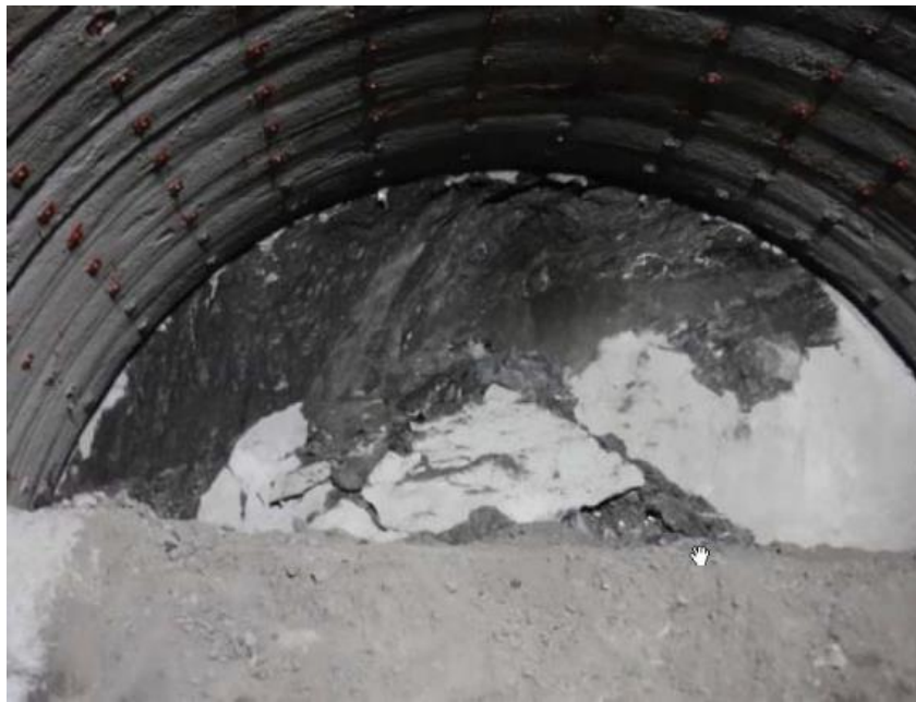
写真 3. 5. 2 291m 地点鏡吹付け崩落状況
