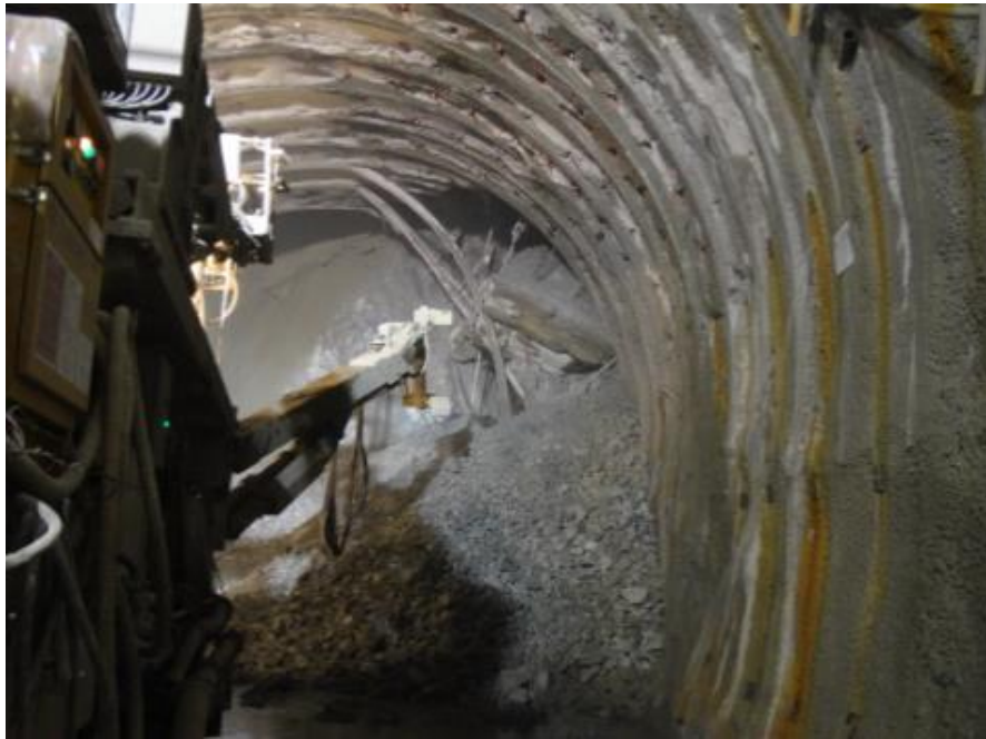
写真 4. 3. 2 TD1608m の崩落状況
