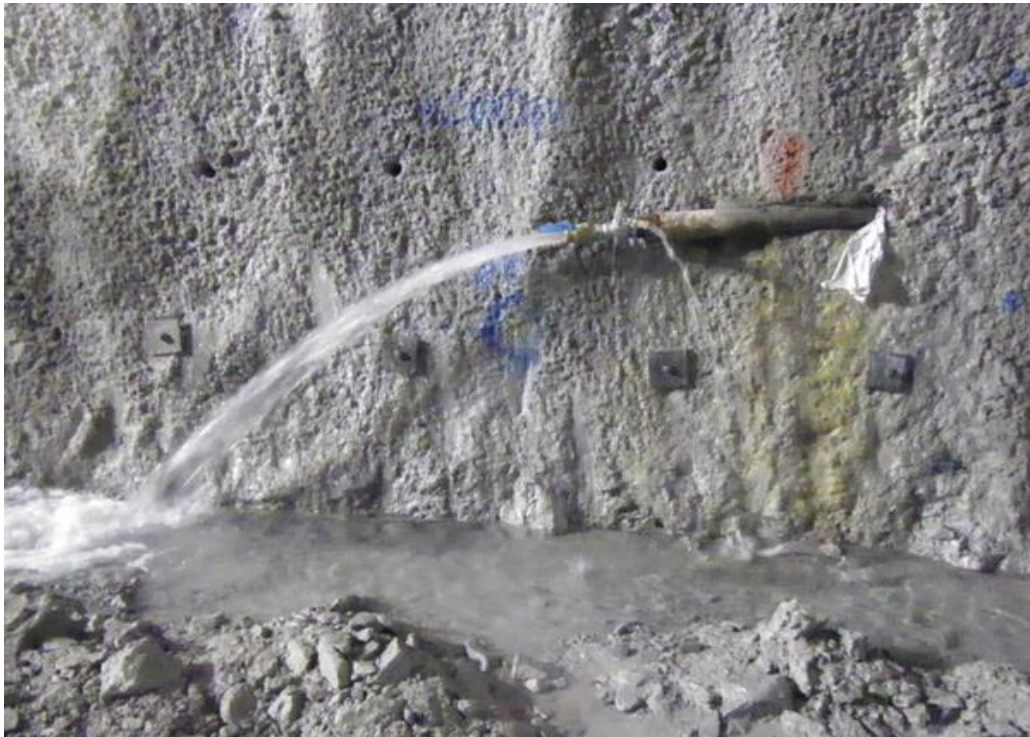
写真 4.3.9 No.6 ボーリング孔湧水状況
