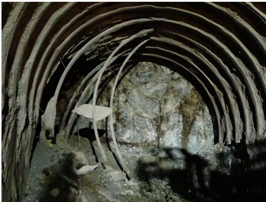
写真 4.3.5 崩落位置状況写真
