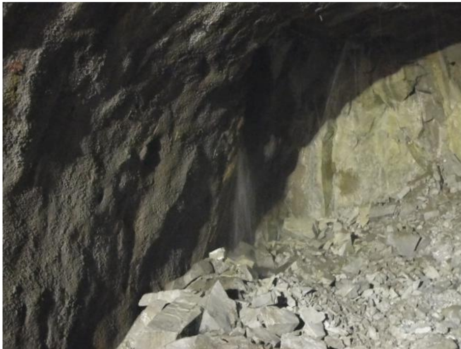
写真 4.3.1 TD915m の崩落状況
