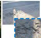
車道にひび割れ発見！
