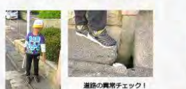
道路の異常チェック! 小さな脚でも子供には危険です!
