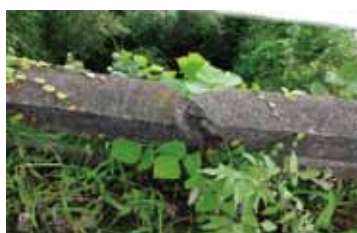
手摺コンクリート欠落
