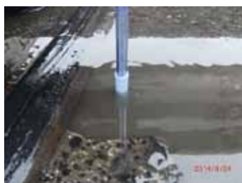
現場実習：アスファルトの陥没
