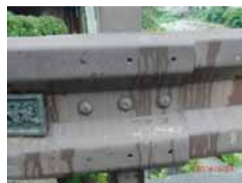
ボルト現場実習：の欠損
