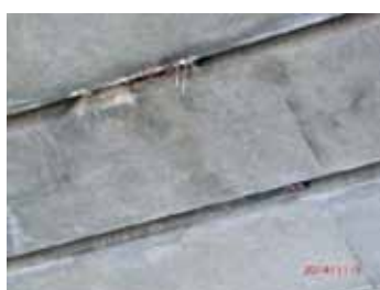
現場実習：つらら状の遊離石灰
