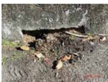
現場実習：排水口のつまり
