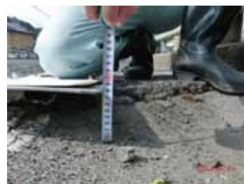
現場実習：橋の端部 8 cm の段差
