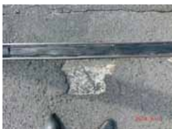
現場実習：鉄筋の露出
