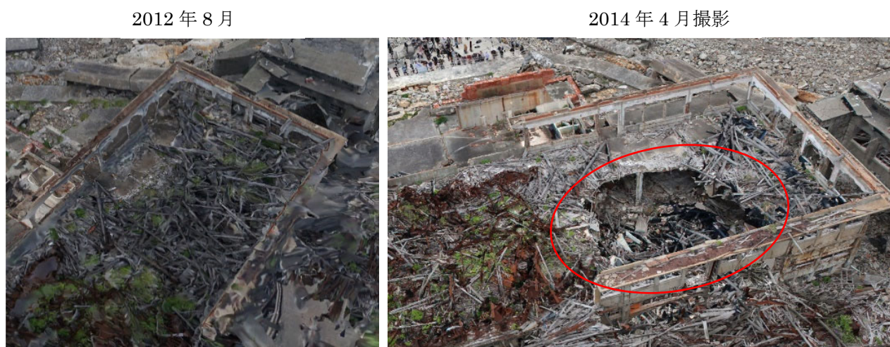
図 2.3.18 会社事務所 2F の床スラブの抜け落ち
