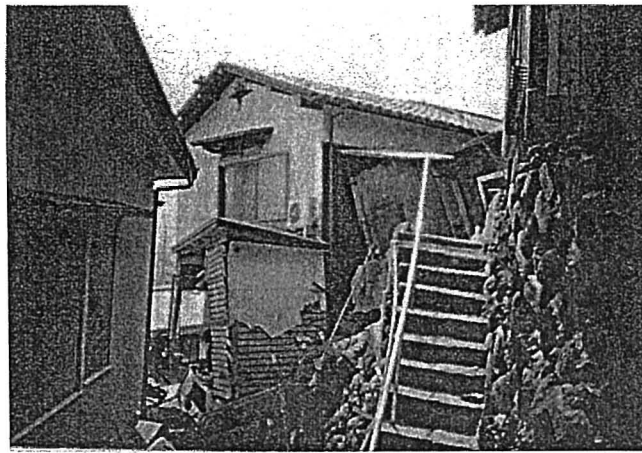
写真 11.1 斜面地の住宅と宅地の被害
