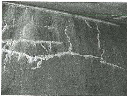
写真-7 主けたのひび割れ状況
